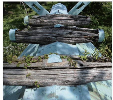
腐朽した鰹木
